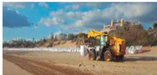
Muro de sacos terreros, Isla Canela
